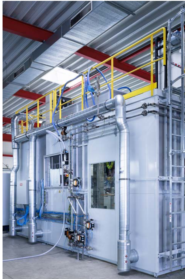
Rückansicht einer gekapselten, GMP-konformen Abfüllanlage inklusive aktivem Belüftungs- und HVAC-System
